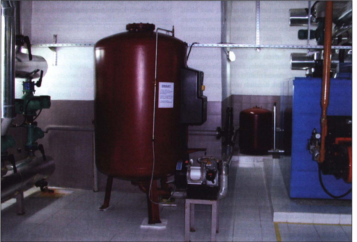
Şekil 16.46. DEĞİŞKEN BASINÇLI KAPALI GENLEŞME TANKI İLE KOMPRESÖRLÜ KAPALI GENLEŞME TANKI UYGULAMA KARŞILAŞTIRMASI
