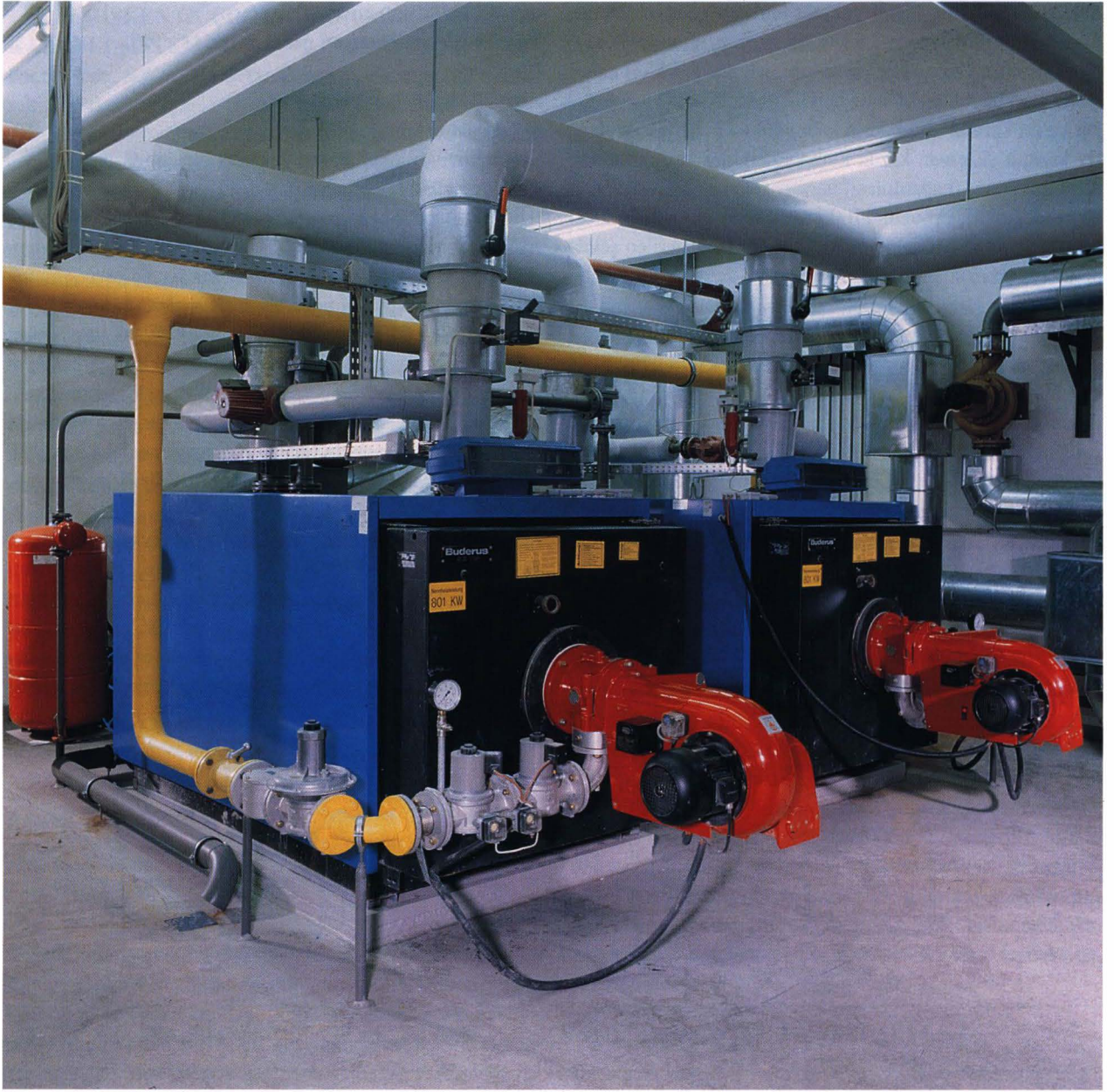
Şekil 1.14. STUTTGART - NORD IN KONGEN YÜK POSTA MERKEZİNDEKİ İKİ DÜŞÜK SICAKLIK KAZANLI SİSTEM (Toplam 1840 kW'lık ısı gücü mevcuttur)
